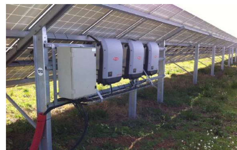
Photo 21 : Exemple d'onduleurs strings fixés à l'arrière des tables de modules (Source : TSE)
