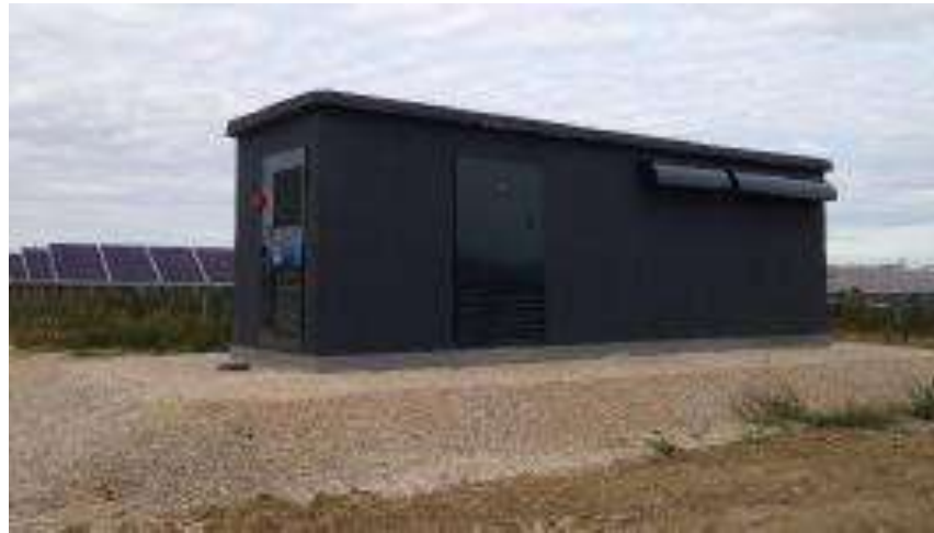
Photo 22 : Exemple de poste de transformation et de poste de livraison (Sources : TSE)
