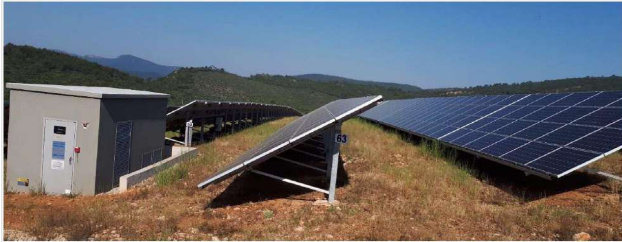
Exemple de support fixe (Source : Auddicé environnement)
